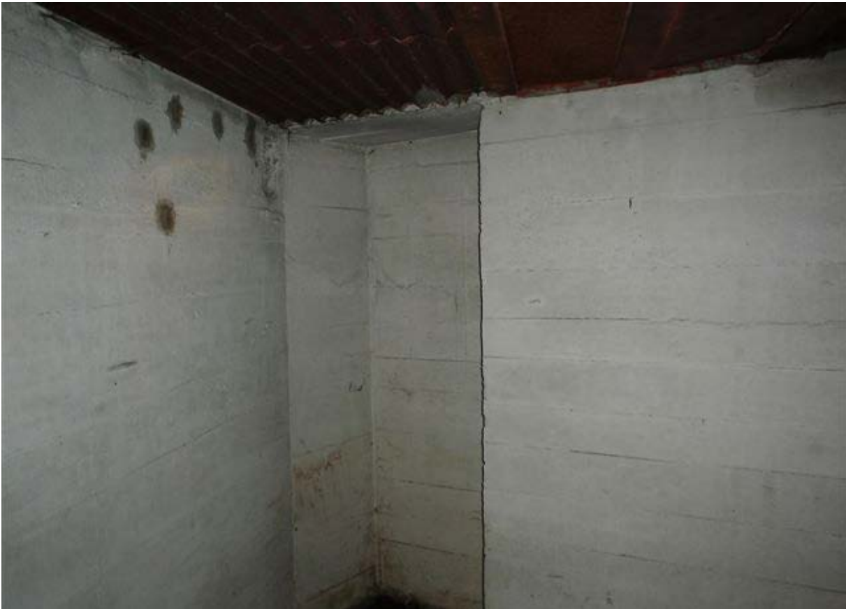
Foto . In deze kelderruimte zijn duidelijk extra schuilmogelijkheden nodig. Het boren van gaten in het plafond geniet de voorkeur boven het ophangen van holle bakstenen (foto Bob Vandendriessche, 2007).
