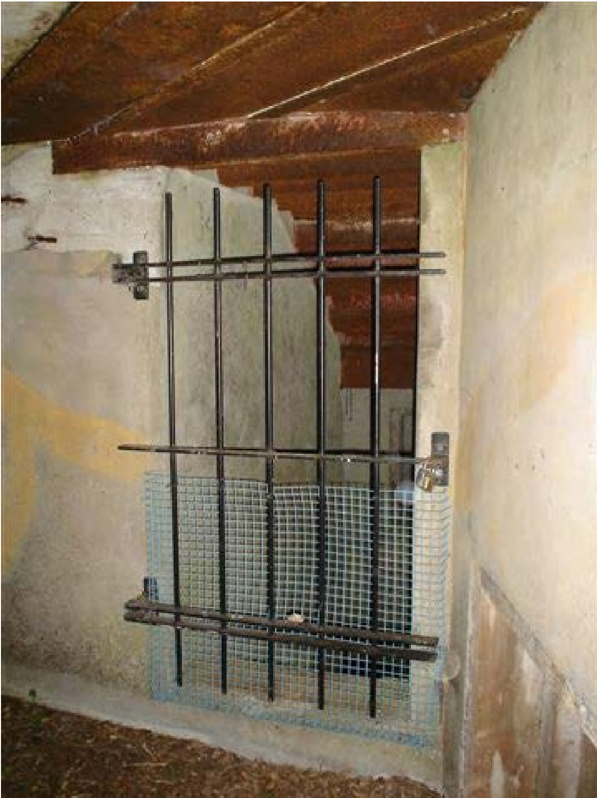
Foto. Bunker afgesloten door twee traliehekken. Het loshangende slot is evenwel inbraakgevoelig, wat vleermuizenverstoring kan teweegbrengen (foto Bob Vandendriessche).
