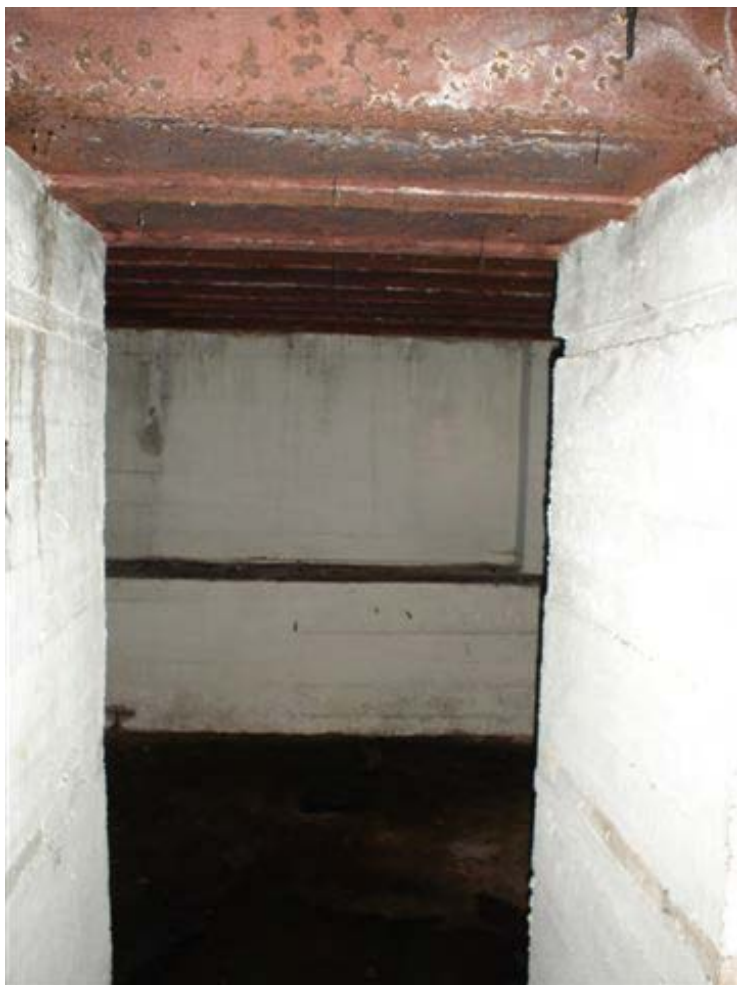
Foto . Een extra deur in dit deurgat kan in de achterliggende kamer een stabiel binnenklimaat met hoge luchtvochtigheid creëren. (foto Bob Vandendriessche, 2007).
