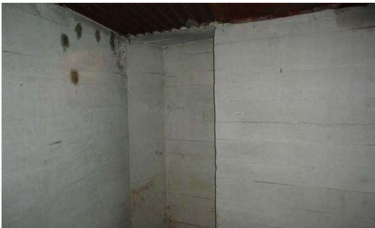
Foto. In deze kelderruimte zijn duidelijk extra schuilmogelijkheden nodig. Het boren van gaten in het plafond geniet de voorkeur boven het ophangen van holle bakstenen.
